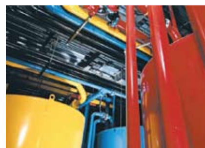
Баки, промышленные резервуары, трубопроводы должны иметь чистый, опрятный вид, обладая при этом стойкостью к агрессивным химическим воздействиям.
